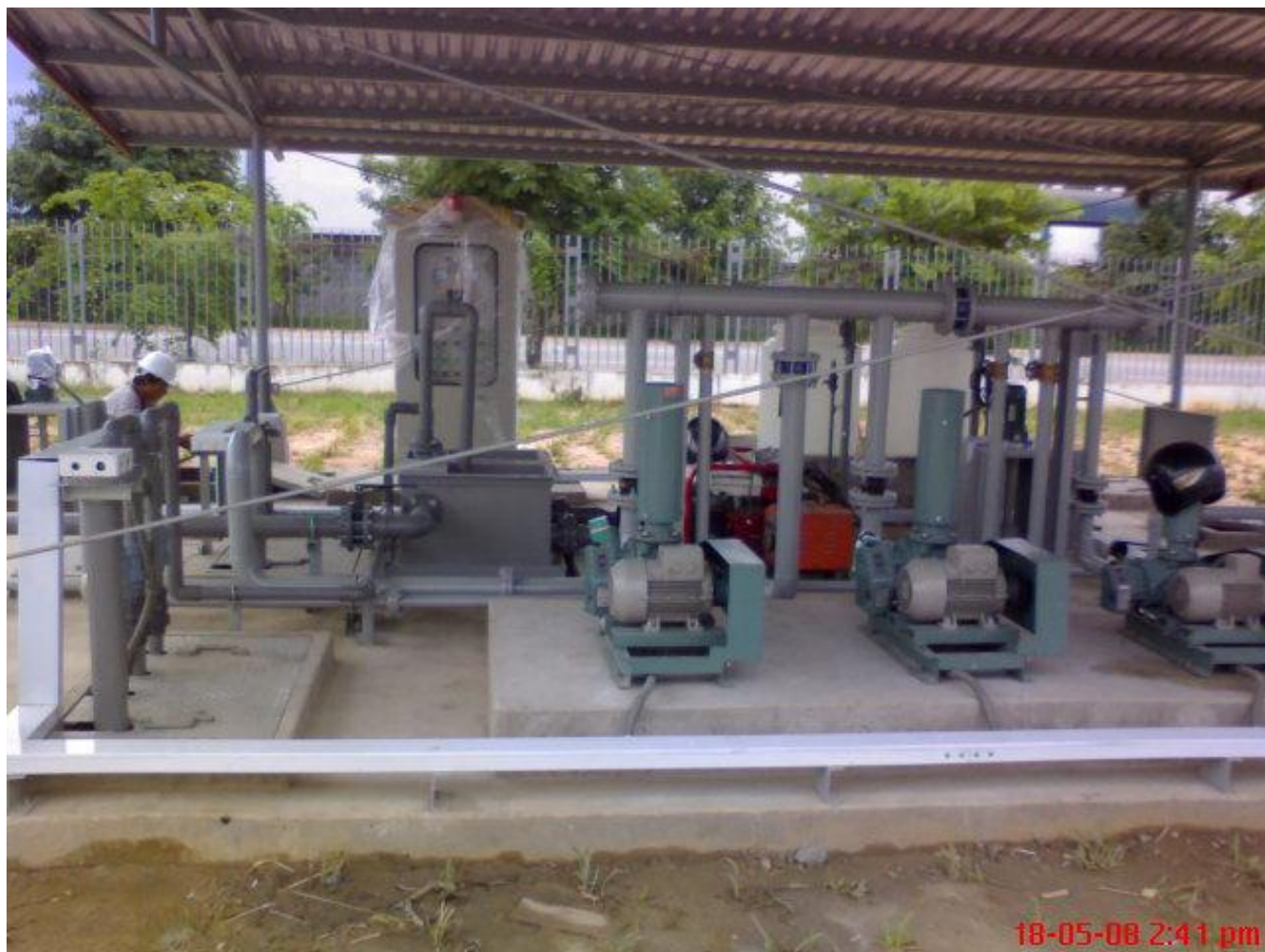
Trạm Xử Lý Nước Thải Sinh Hoạt, Lưu Lượng 5m 3 /h
