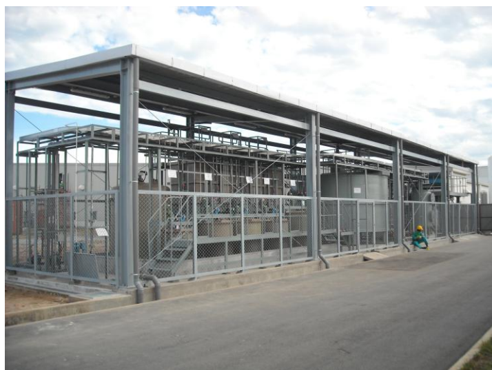
HTXL nước thải Nhà máy Saigon Stec – KCN VSIP 2 Bến Cát – Bình Dương (nước thải công nghiệp)
