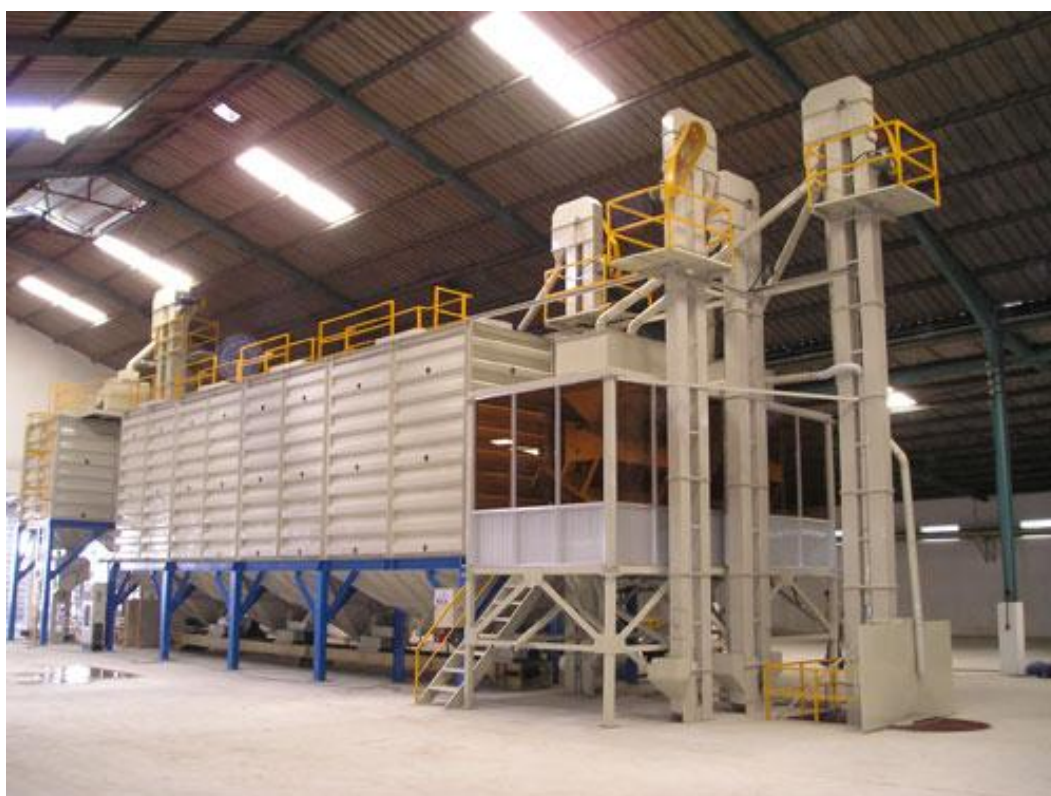
Lắp đặt hệ thống tồn trữ hạt và tách hạt
