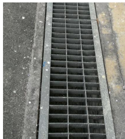
Mương thoát nước
